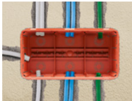
Identificarea liniilor electrice
