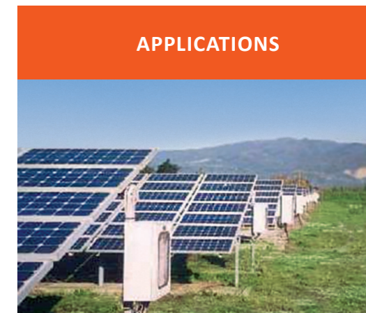
Extérieur : stades, marchés, camping, fermes photovoltaïques,...
